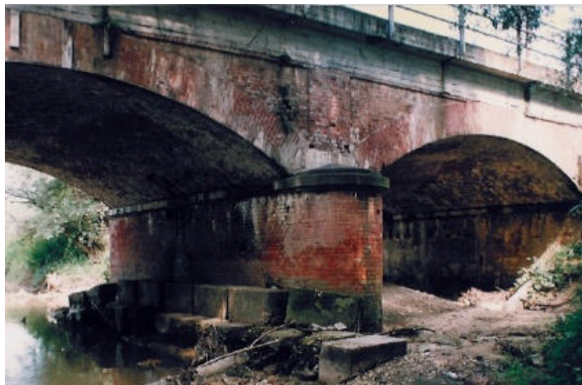
Figura 3 Pila con rostro, ponte Meletta – linea Trofarello-Cuneo, progr. 19+256 (Archivio FS-TO)
